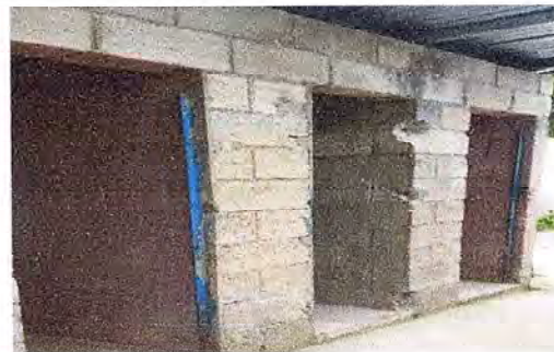
Foto 4: Las puertas de metal anteriores de los servicios sanitarios fueron retirados por encontrarse en mal estado y deterioras.
